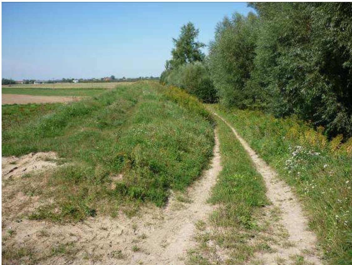
Fot. 4 Nieumocniony zjazd na międzywale w km 4+420
