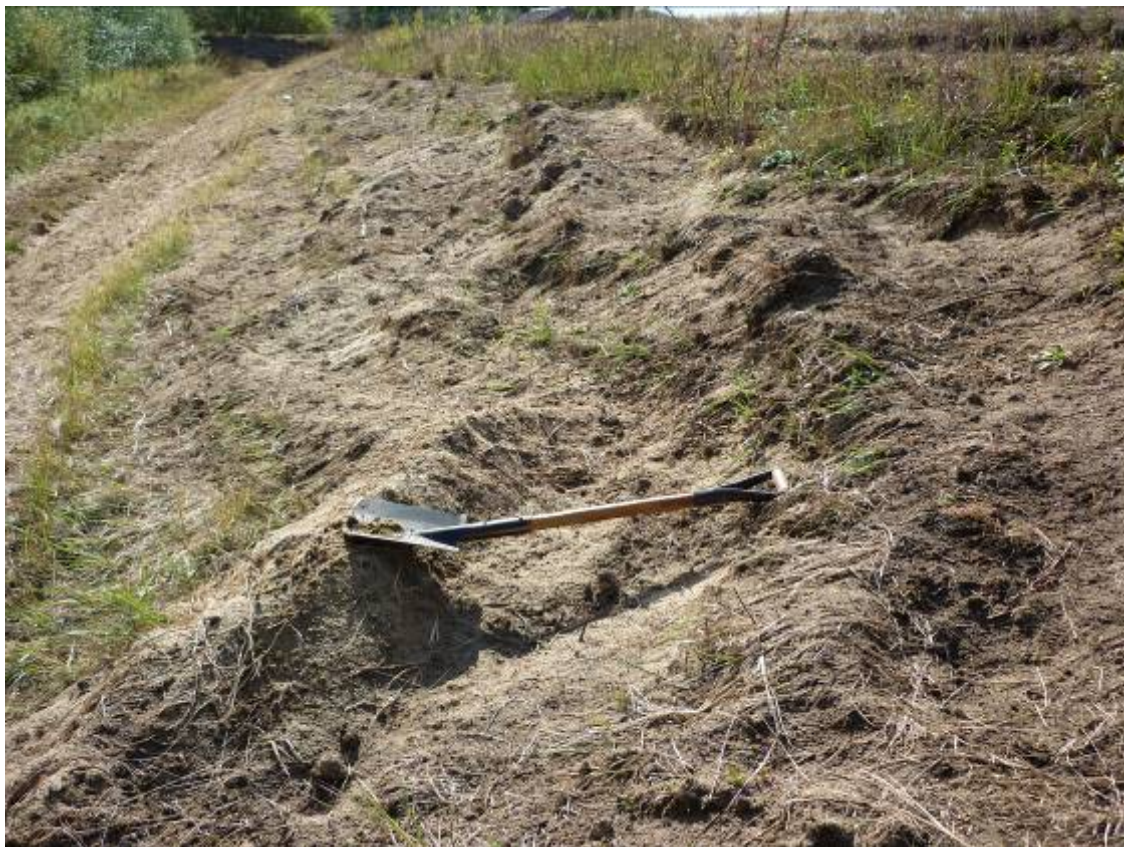
Fot. 12 Źle umocniona skarpa nawet w trakcie koszenia jest dewastowana
