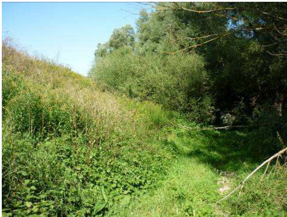
Fot. 6 Opanowana przez chwasty odwodna skarpa wału
