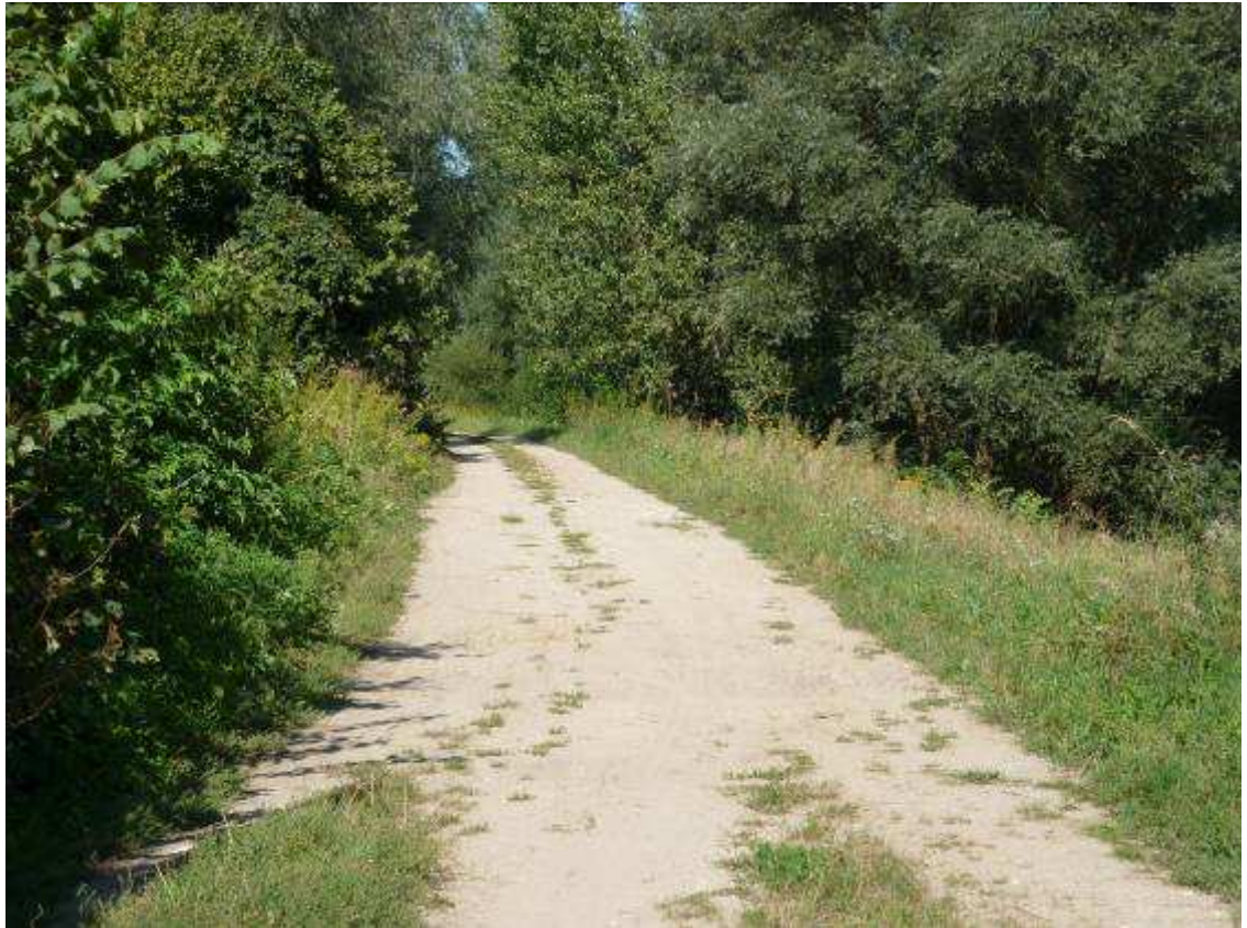
Fot. 30 Roślinność drzewiasta dochodząca do korony wału.
