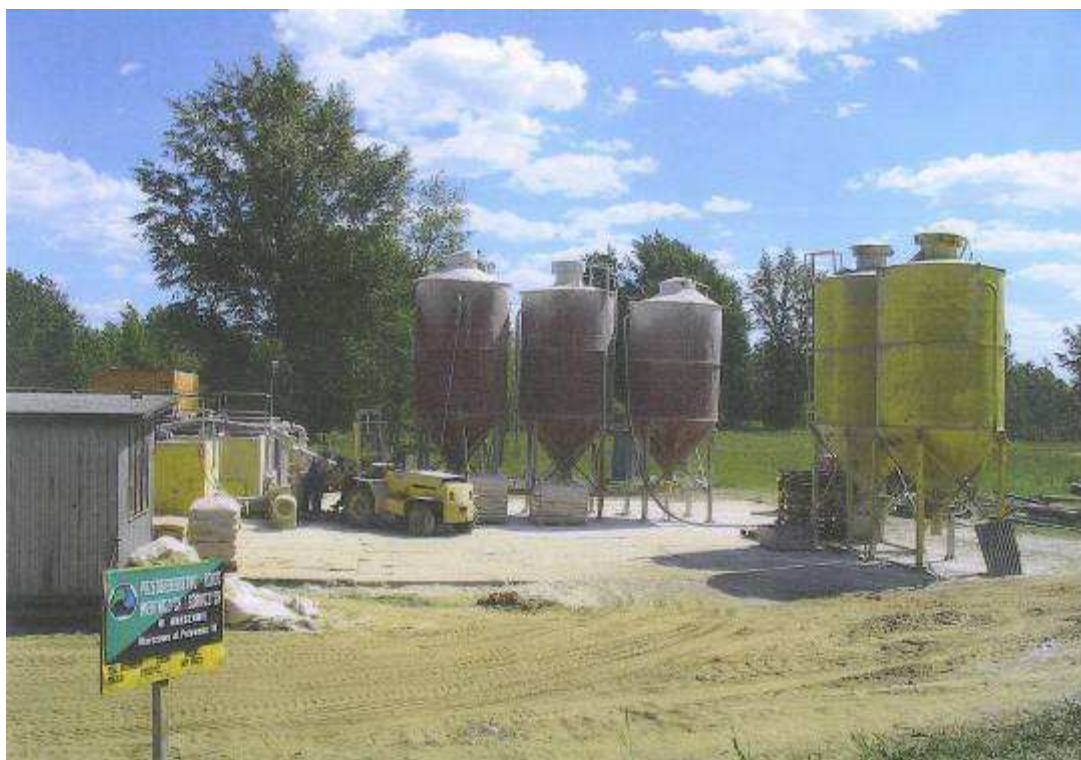
Fot. 34 Stacja przygotowania zawiesiny bentonitowo – cementowej
